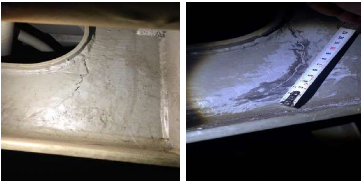
Рисунок 3.14 – Пример трещины хребтовой балки вагона модели 61.4516
